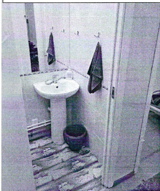
Фото 46 – Бассейн (туалетная комната)
