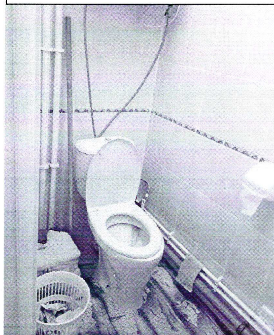
Фото 45 – Бассейн (туалетная комната)
